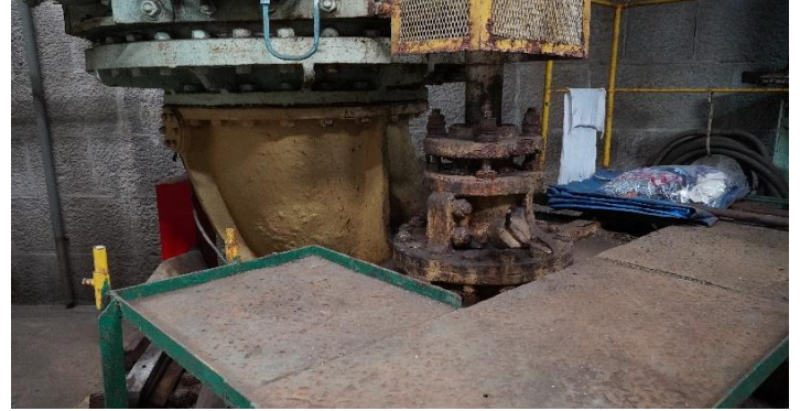
JMUに現存する排水ポンプ
